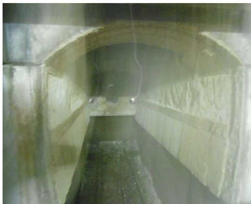
写真 4-55 主燃焼炉内の状況
