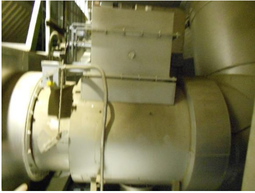
写真 4-59 排ガス冷却設備
