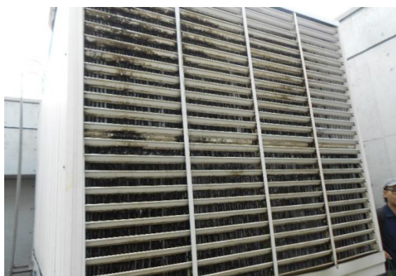
写真 4-51 冷却塔室外機外部 (錆の発生や腐食)
