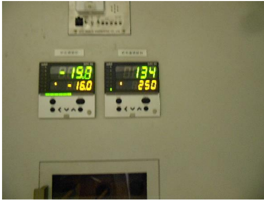
写真 4-61 電気集じん機排ガス温度設定
