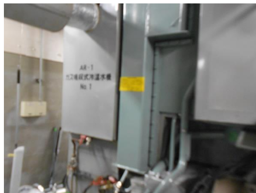
写真 4-50 吸収式冷温水発生機 (錆の発生)
