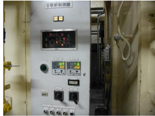
写真 4-62 炉制御盤及び炉枠ケーシング
