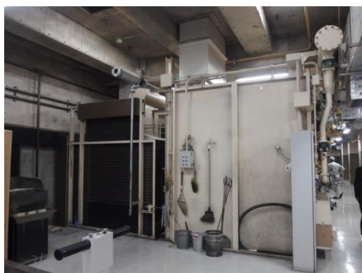
写真 4-17 火葬炉設備（前室と火葬炉本体）
