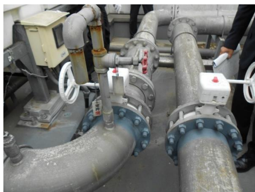
写真 4-53 冷却塔室外機配管 (錆の発生)
