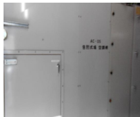
写真 4-54 エアハンドリングユニット (外板の錆の発生、腐食)
